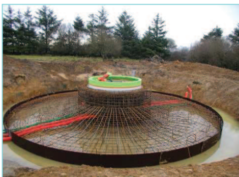
Photo 35 - Socle en cours de construction et accumulation d'eaux (Source EDPR)
